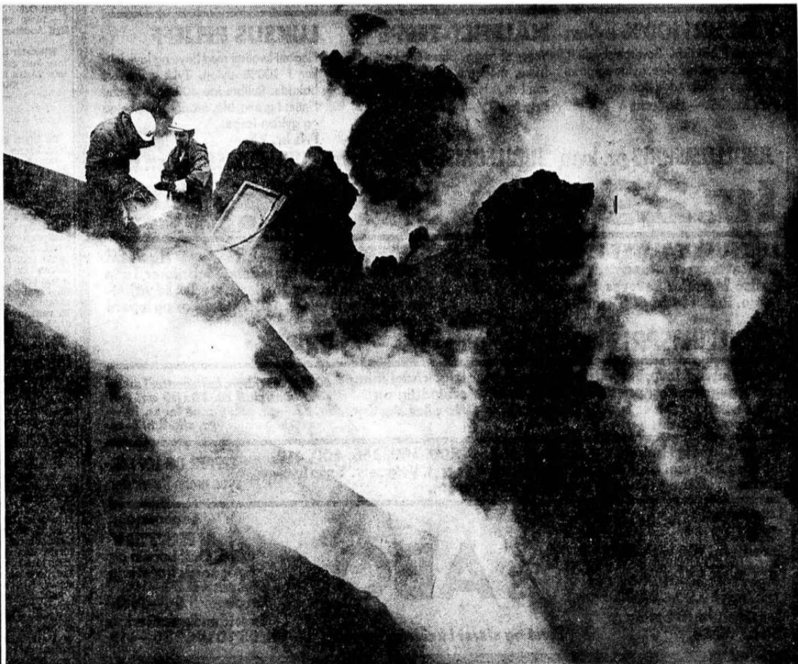
Det er langt fra ufarlig å delta i redningsarbeidet i Vestmannaeyjar, men det mangler ikke frivillige. Disse to er i ferd med å reparere vannledningen til byen opp på en lavarygg. Sivilforsvaret i Island fører streng kontroll med alle som drar frem og tilbake mellom Reykjavik og Vestmannaeyjar.
