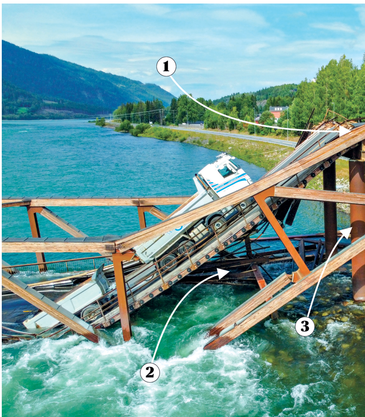
Disse punktene er blant dem som får Engen til å tenke som han gjør: 1. Trebjelken er spjæret på langs. 2. Treverket under kjørebanelen buler ut. 3. Stålfundamentet luter noe fremover. Foto: Stian Lysberg Solum, NTB
