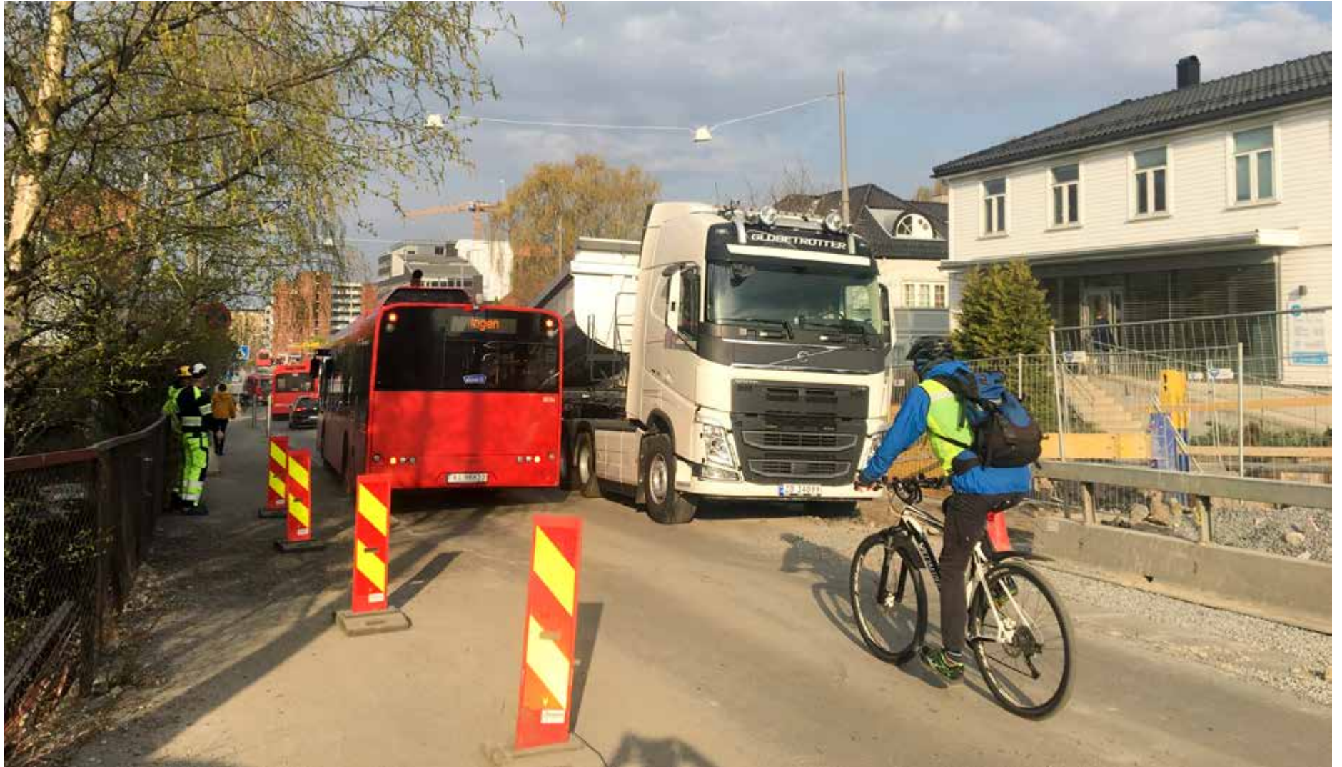
Sporveien oppgraderer Grefsenveien. Arbeidene skal pågå frem til neste vår. Flere gater skal rustes opp for å ta imot nye trikker. Foto: Astrid Løken
