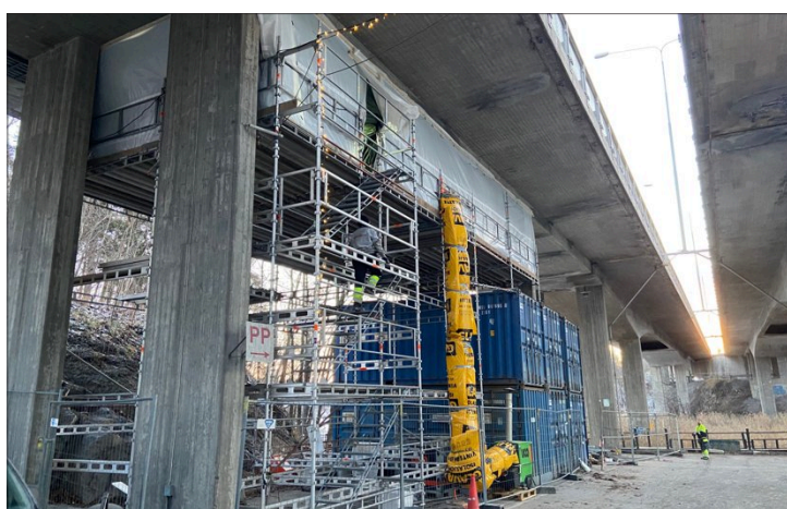
I årene fremover kreves det mye vedlikehold av E18-broene forbi Sandvika. I desember i fjor førte vedlikeholdet til stengte veier og mye trafikkaos. Broen fra 60-tallet må skiftes ut i løpet av noen år.
